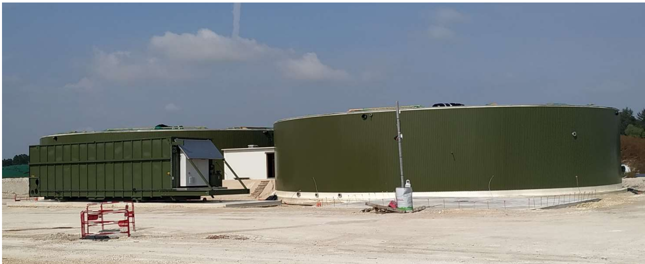
Figure 2 : Digesteur et Post-digesteur du projet porté par LES VALLEES ENERGIE (Site en construction)
