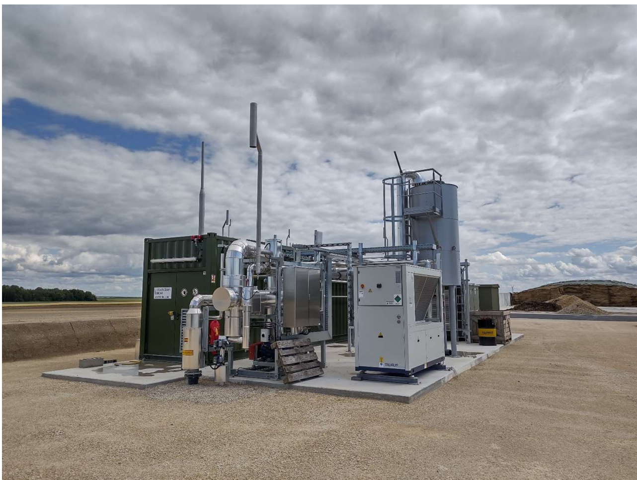
Figure 4 : Unité d'épuration de biogaz
